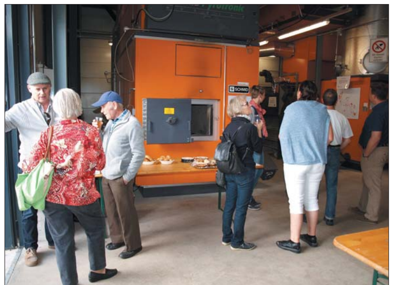
Auf grosses Interesse stiess die Holzschnitzelfeuerung der Korporation Weggis.
